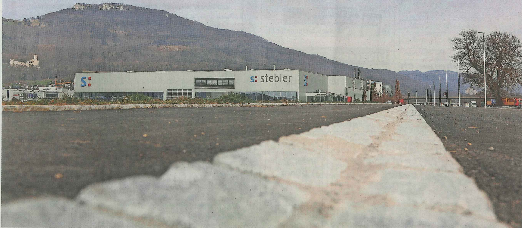
Die Erschliessungsstrasse ist bereit für den Swiss-Nutrivalor-Bau, der neben der Firma Stebler zu stehen kommen wird.
